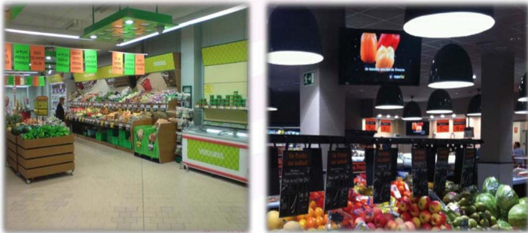
Figura 5: Vista general de la instalación de iluminación en el supermercado objeto de estudio.
