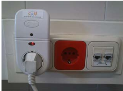
Figura 4: Conexión smart meter inalámbrica
