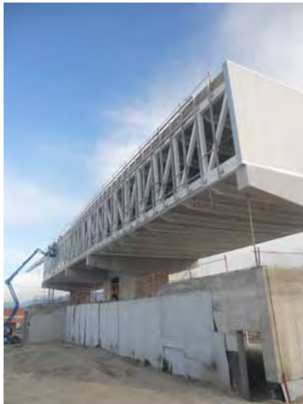
Cerrando el edificio en la cara Oeste y preparando subestructuras para los vidrios de la fachada Norte
