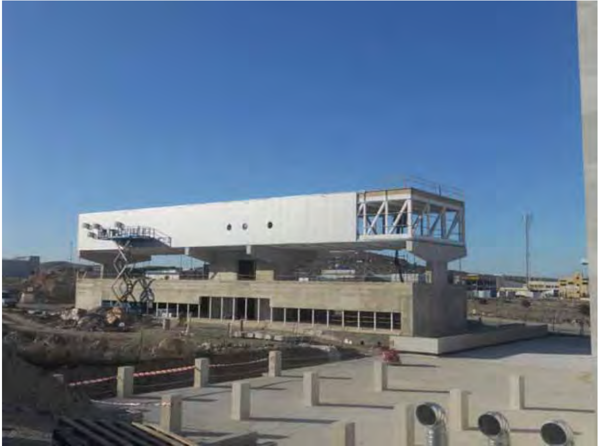
Cerrando la fachada Sur y abriendo los taladros para conectar los difusores térmicos
