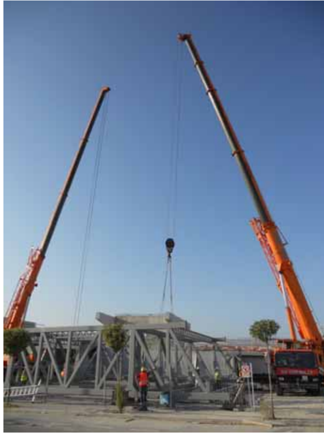
Izado del módulo central de la estructura metálica que formaliza la planta segunda
