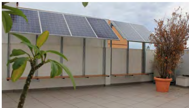
Imagen del campo fotovoltaico instalado
